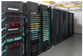
Tủ IT Server
