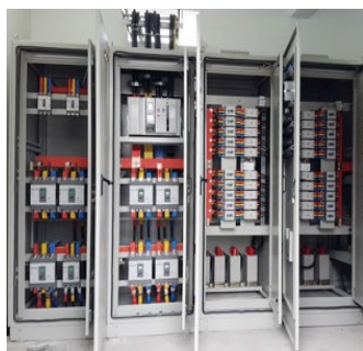
Hệ thống tủ điện
