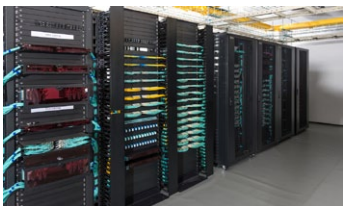
Tủ IT Server
